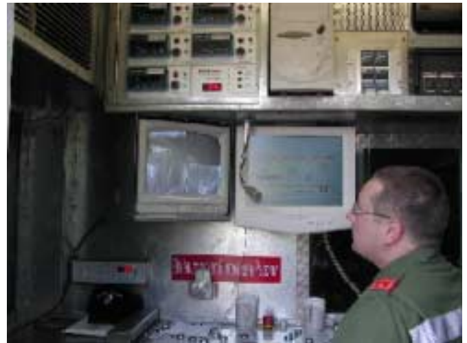
19.10.2002: Hot-Container-Training (Der Überwachungsraum)
